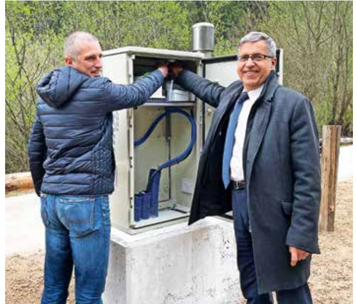
Na kopališču Pustotnik sta Janez Žakelj (na fotografiji na desni) in Gašper Kleč odprla malo čistilno napravo. / Foto: Tanja Mlinar
